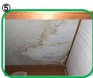
天井の雨漏りを確認
